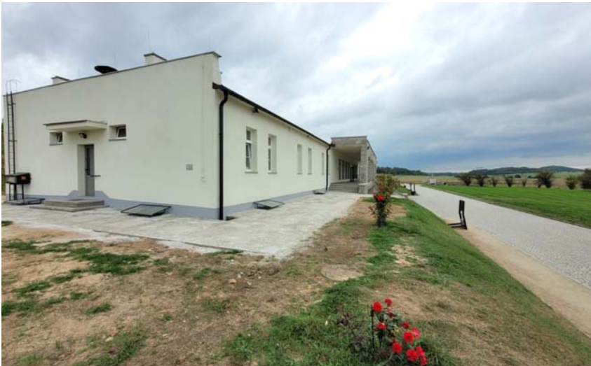
Remont oraz izolacja przeciwwilgociowa budynku dawnego kasyna SS Muzeum Gross-Rosen w Rogoźnicy, 2023
